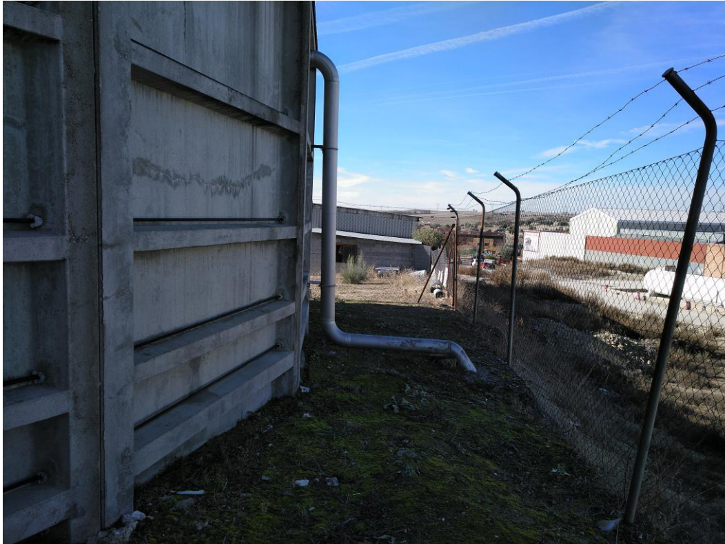
DEPÓSITO DE AGUA POTABLE. -SECTOR CERRONES- TUBERÍA DE ENTRADA SISTEMA DE PICADAS I.
