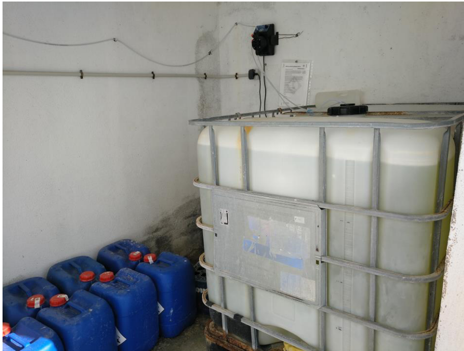
DEPOSITO DE AGUA POTABLE MUNICIPAL. -PARAJE PERIQUITO- CLORACION SISTEMA AUTOMÁTICO DEPÓSITO Y ALMACEN DE CLORO
