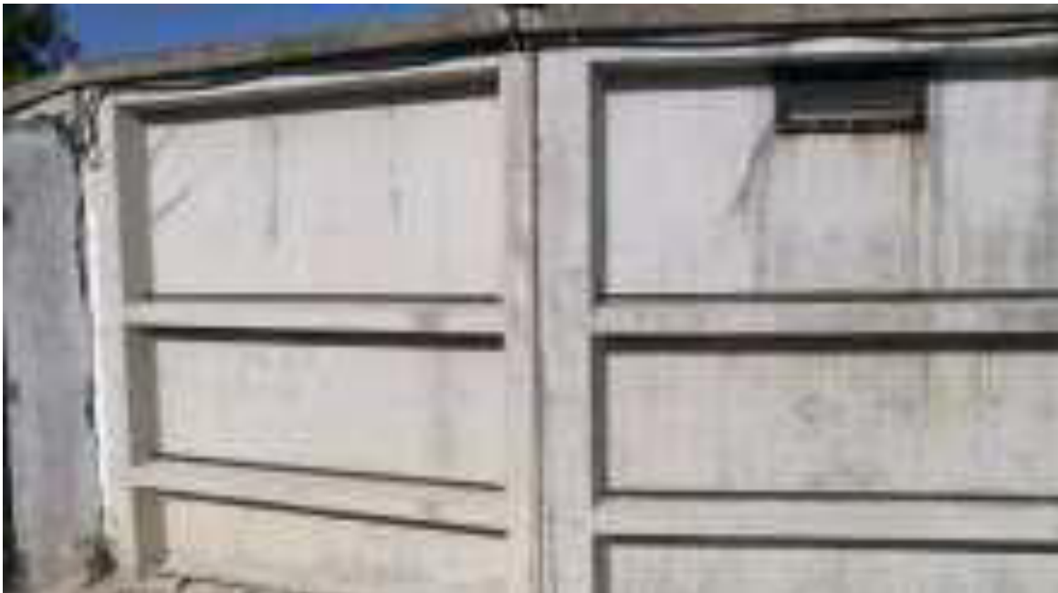
DEPÓSITO DE AGUA POTABLE. -SECTOR CERRONES- PANELES DE HORMIGÓN PREFABRICADO. CASETA DE CLORACIÓN
