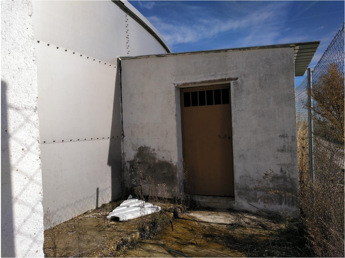
DEPOSITO DE AGUA POTABLE MUNICIPAL. -PARAJE PERIQUITO- CASETA ALMACEN. CLORACIÓN
