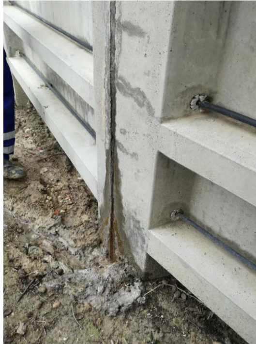
FUGAS DEPOSITO DE AGUA POTABLE MUNICIPAL -SECTOR CERRONES-
