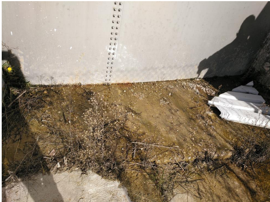
FUGAS DEPOSITO DE AGUA POTABLE MUNICIPAL -PARAJE PERIQUITO -
